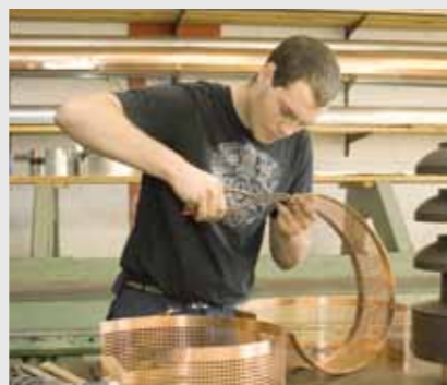
Façonnage d'une tôle de ventilation Préparée à l'atelier, la tôle est ensuite montée au pied de la toiture.
