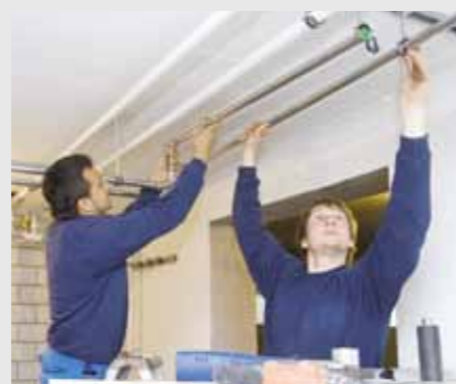
Montage de la distribution en sous-sol Au sous-sol, l'eau potable est amenée jusqu'au chauffe-eau, puis jusqu'aux divers consommateurs (douche, cuisine, lavabos) grâce à un système de tuyauteries.
