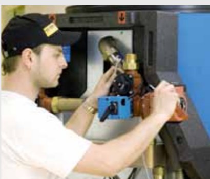
Entretien et dépannage Quand l'eau ne coule plus, on fait appel à un spécialiste. Les installatrices et installateurs sanitaires sont rapidement sur place.
