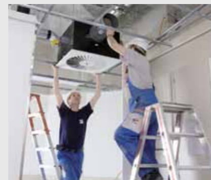
Raccordement des gaines de ventilation Le montage des canaux d'après les plans établis constitue la tâche principale des constructrices et constructeurs d'installations de ventilation.
