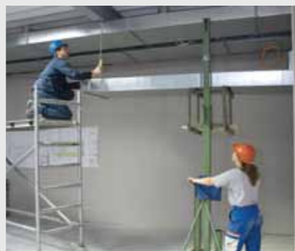
Montage des plafonds amovibles Les constructeurs d'installations de ventilation travaillent souvent en équipe. L'installation des gaines de ventilation n'est possible qu'en équipe, en suivant les instructions de montage.
