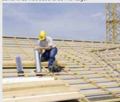
Travail sur le toit Les installations de ventilation vont souvent jusqu'au toit. Il s'agit en partie de conduites d'évacuation (photo).
