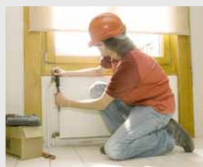
Corps de chauffe (radiateurs) Le montage final des corps de chauffe s'effectue à la fin du chantier. Il exige de traiter l'environnement et le matériel avec la plus grande précaution.
